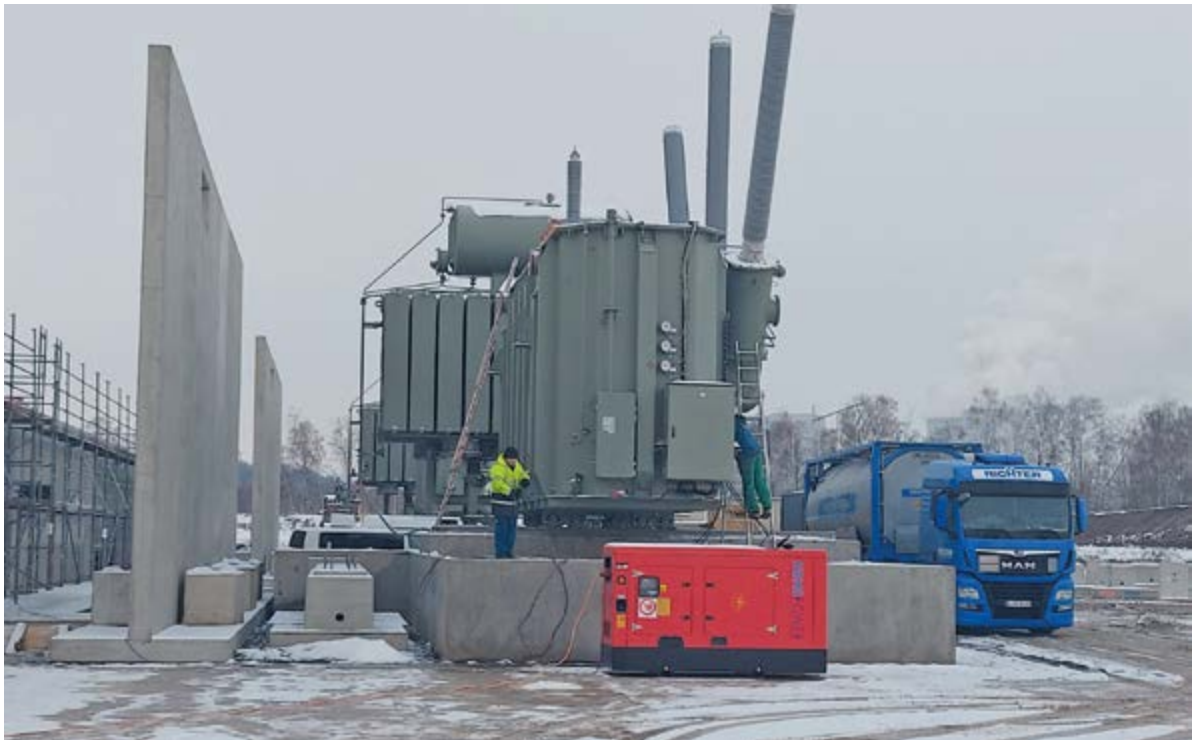
Brandschutzwände für einen Großtrafo im Energiepark Witznitz.
