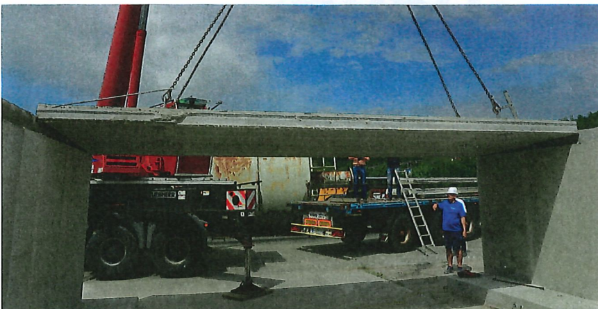
Guter Fugenverbund – einfach anheben reicht nicht, damit der Fugenverguss aufbricht. Foto: BVSF
